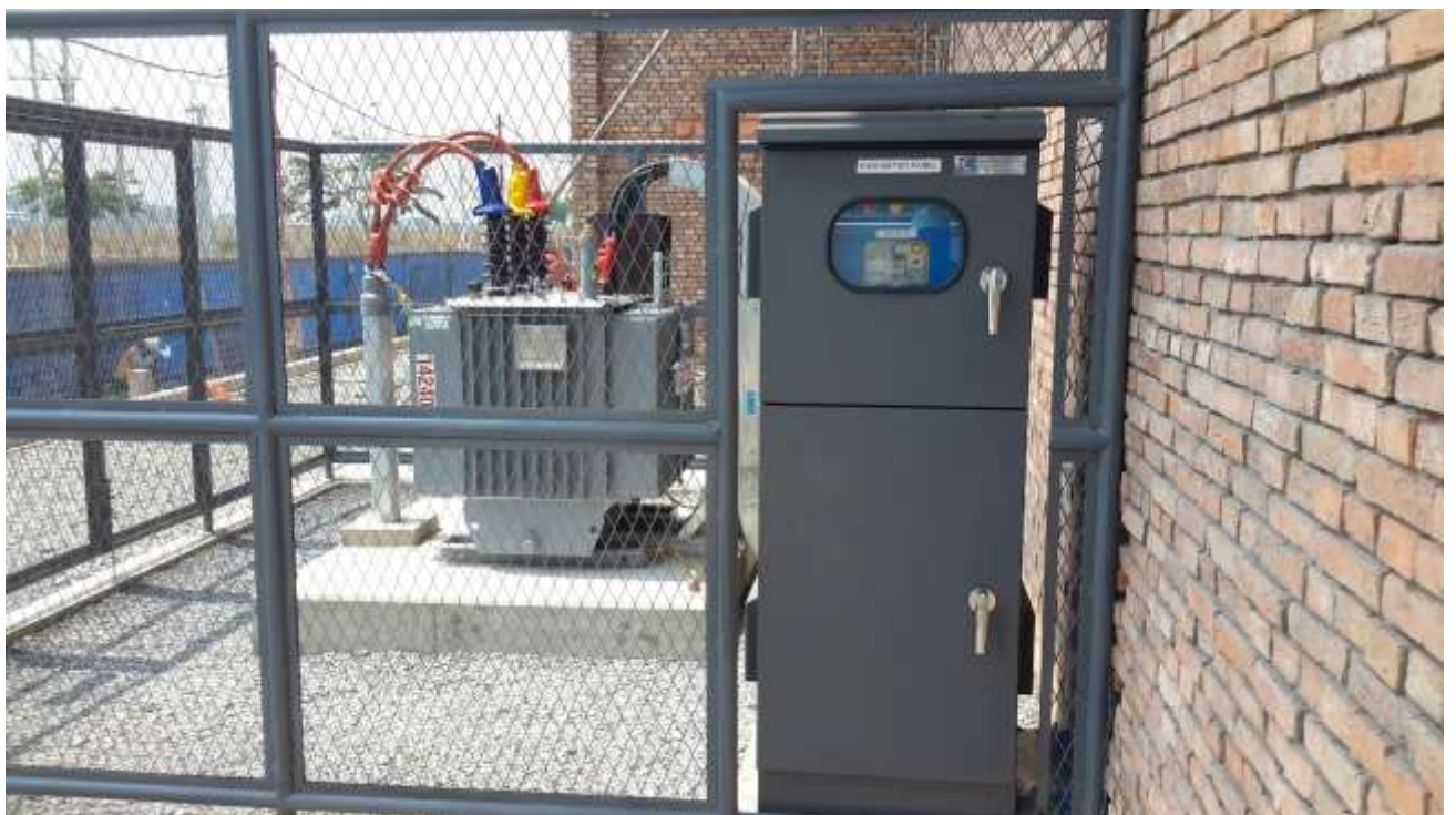
Install substation 400KVA Thi công lắp đặt Máy biến áp 400KVA NHÀ XƯỞNG DAIWA HOUSE
