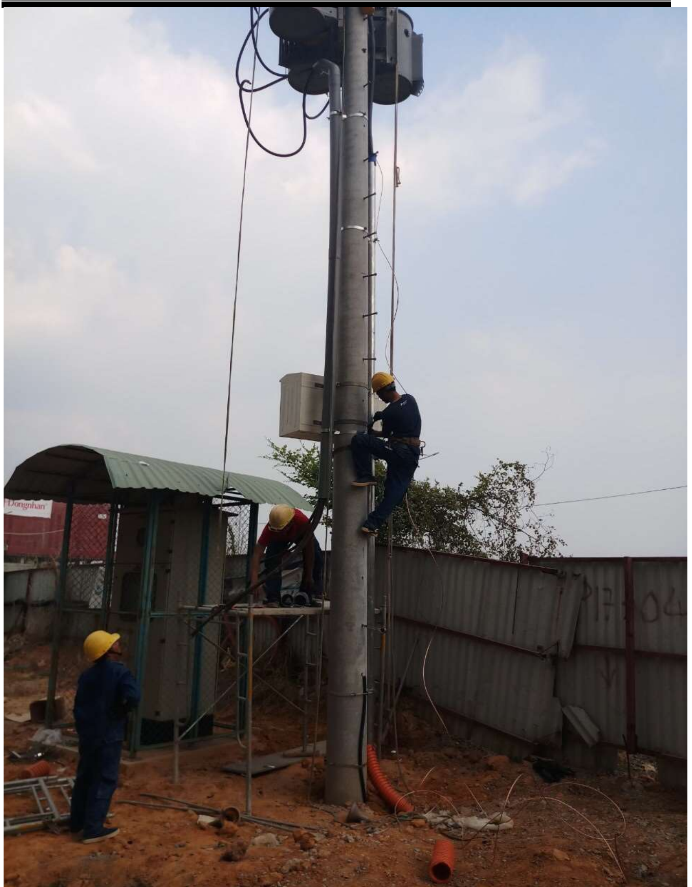
METRO BEN THANH - SUOI TIEN ĐIỆN TẠM TUYẾN METRO BẾN THÀNH – SUỐI TIÊN
